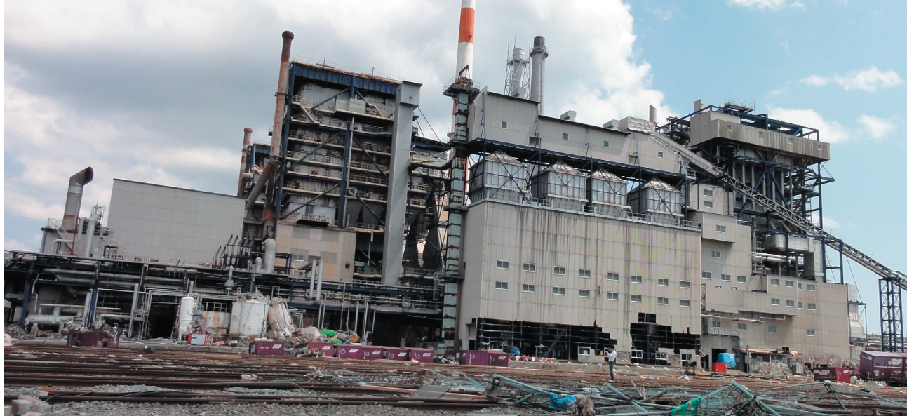
被災した日本製紙株式会社の工場（宮城県石巻市大川地区）
