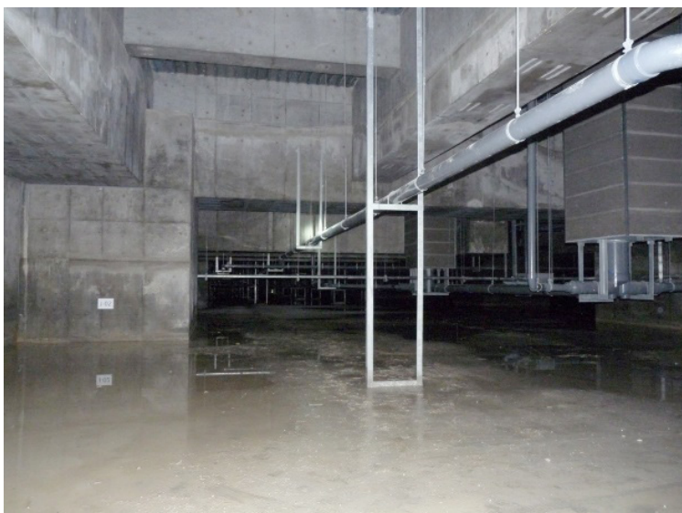
写真 | 水産卸売場棟の地下空間に溜まった地下水
